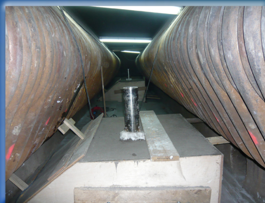
Vue intérieure de la chaudière et du cendrier
