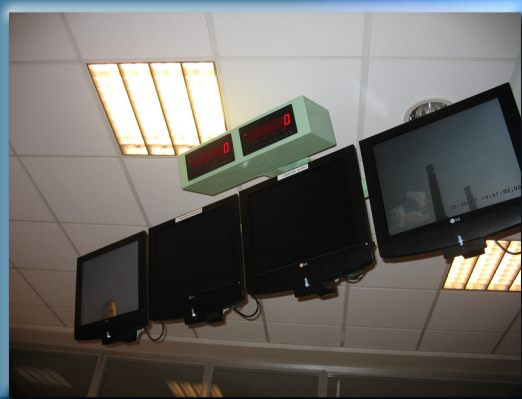
Salle de contrôle
